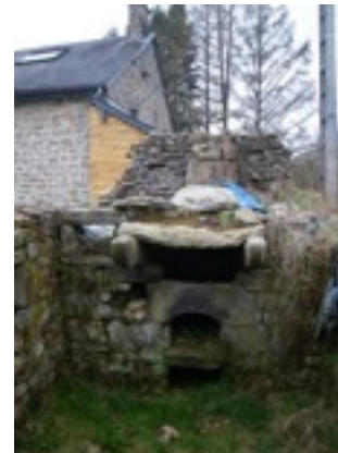
bouche du four et départ du conduit
