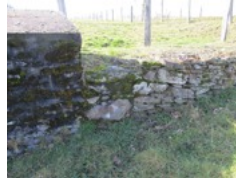
Accroche du muret de soutènement
